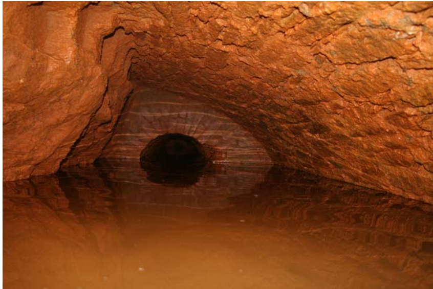
Abb.18 : Verbruchstelle im Orgel Stolln
