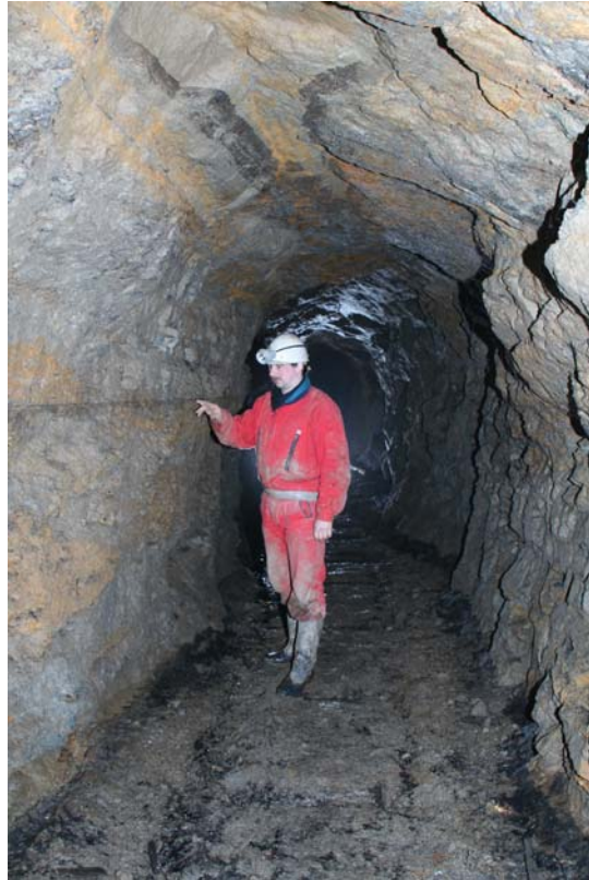
Abb.4 : Standwassermarken im Querschlag Hermann
