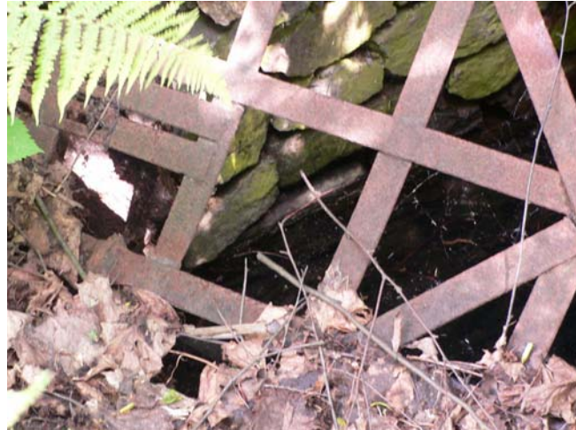
Abb.11 : Standwasser am Mundloch des Tiefen Bauch Stollns
